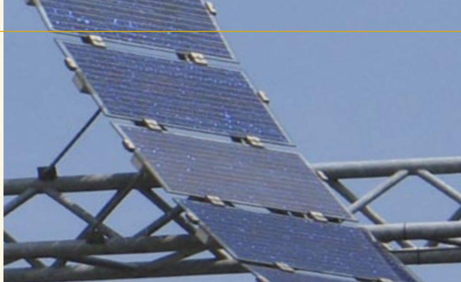
Et svævende solpanel løftet op mod lyset i Eriksgade på Vesterbro
